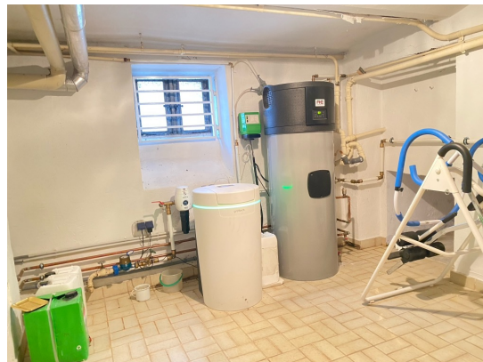
Kellerraum 2 mit Grünbeck Wasseraufbereitung und Wärmepumpenboiler
