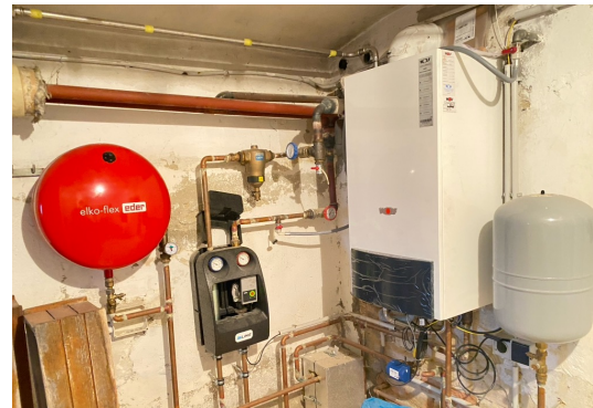
Heizraum mit Wolf Brennwerttherme
