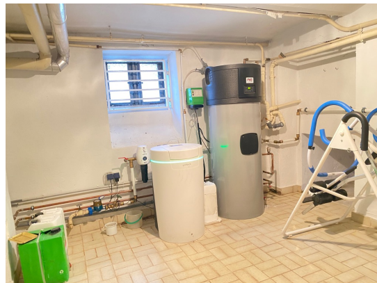
Kellerraum 2 mit Grünbeck Wasseraufbereitung und Wärmepumpenboiler
