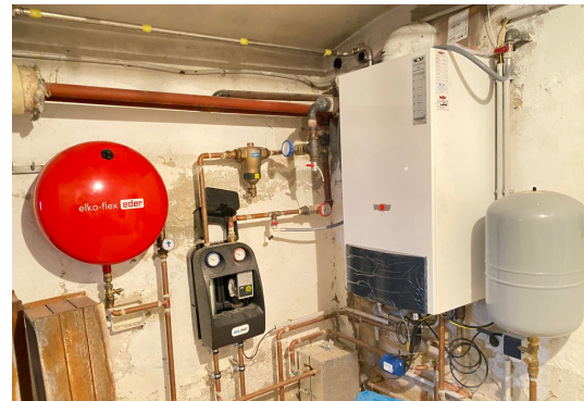
Heizraum mit Wolf Brennwerttherme
